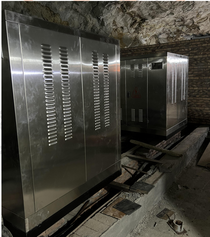
井下+350m 中段变电硐室更换的干式变压器
